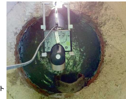
マンホール内に設置している例 マンホール内部に入らないで取り外しできます
